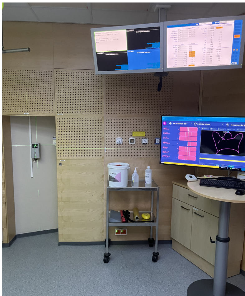
Figur 66: Skjermer på den ene siden av behandlingsrommet. Foto: Sykehusbygg HF.
