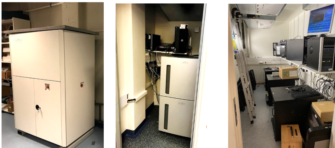
Figur 57: Bilde til venstre og i midten: Styringsenhet for linak og Pc-er ved Sørlandet sykehus. Bilde til høyre Datarom for flere linaker samlet ved St. Olavs Hospital. Foto: Sykehusbygg HF.
