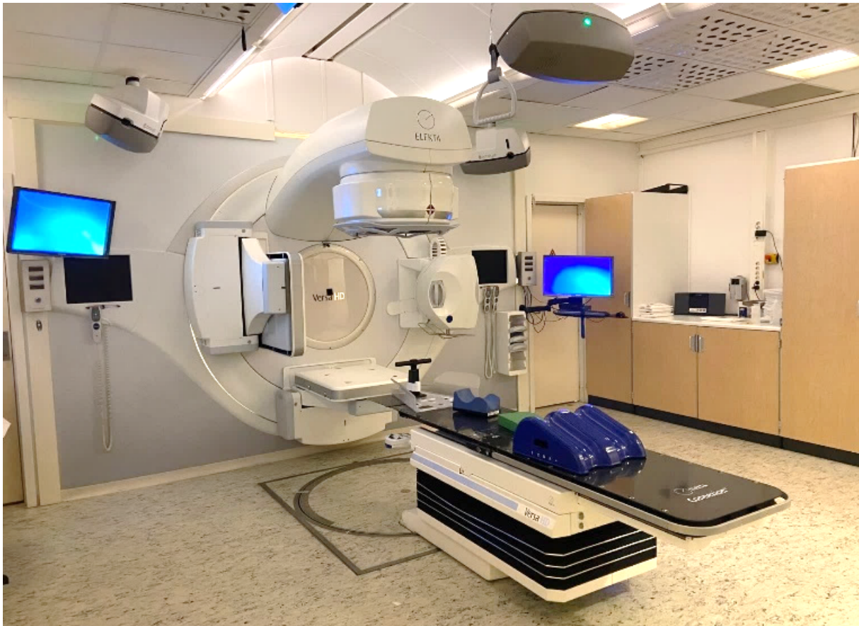
Figur 4: Strålebehandlingsrom med linak, St. Olavs Hospital, Trondheim. Foto: Sykehusbygg HF
