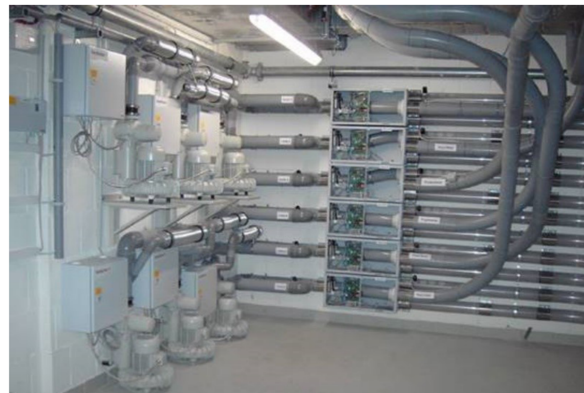
Figur 111: Eksempel på vekslesentral for rørpost.
