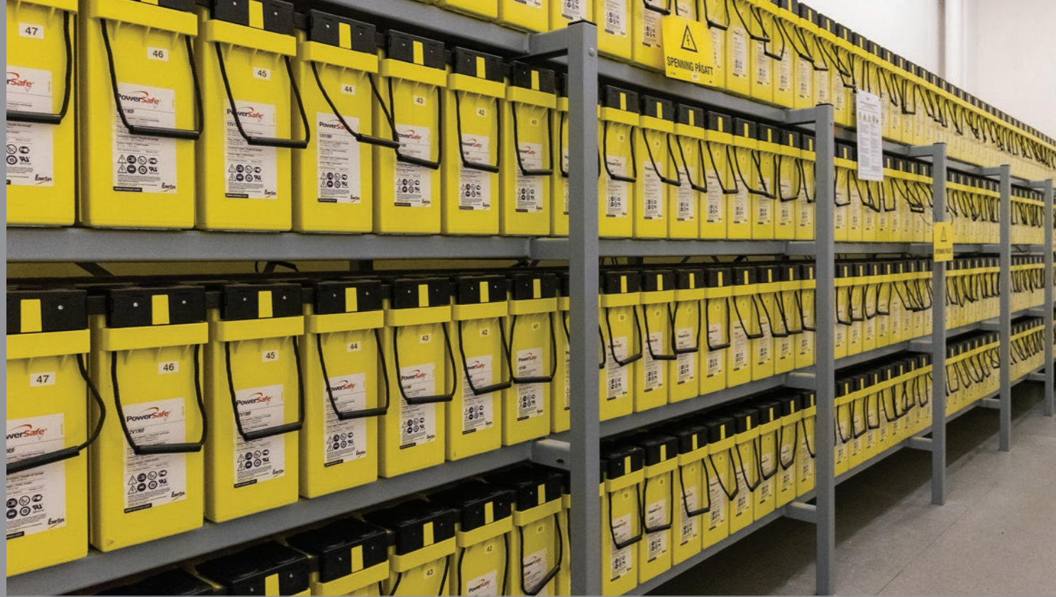
UPS-rom (nødstrøm) i KU1.
