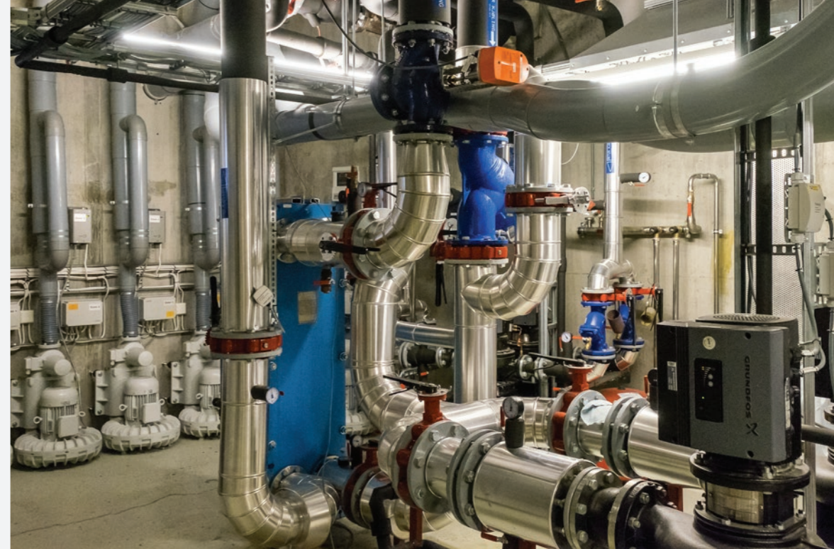
Fjernvarmeanlegg i DU1.
