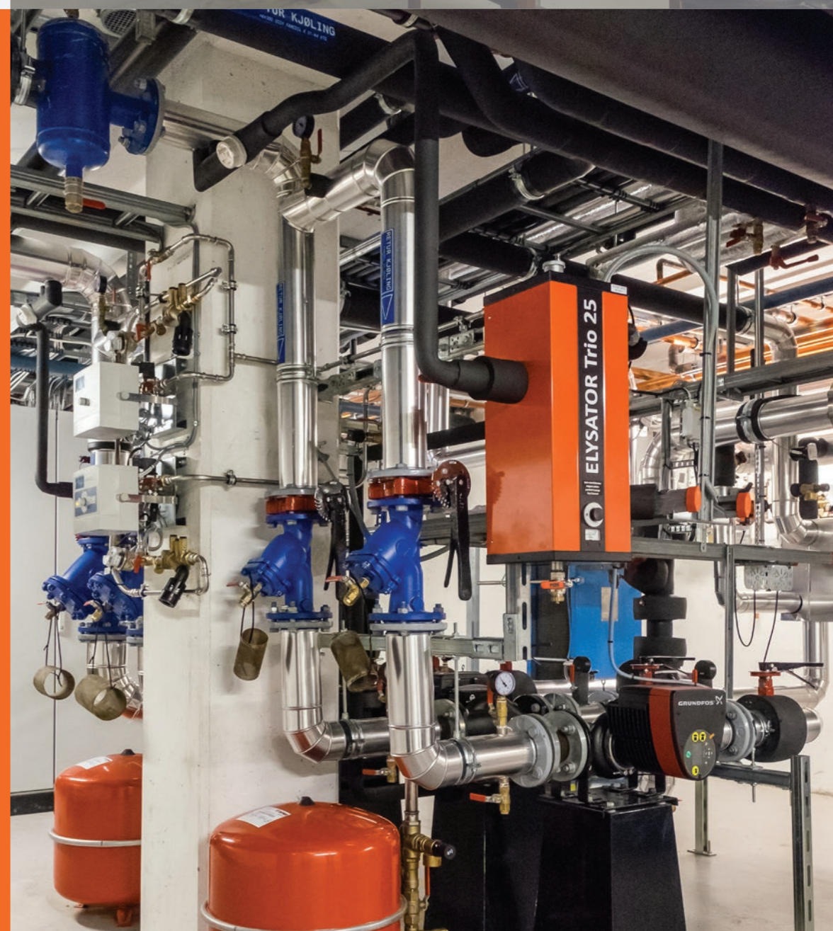
Rørteknisk sentral i KU2.
