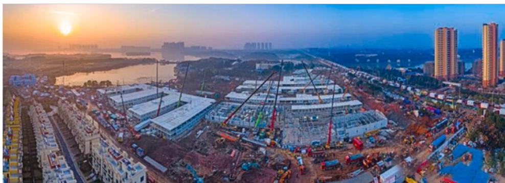
Figur 3.11 Byggeprosessen av Leishenshan sykehus i Kina. Kilde: Chen et al. Foto: Huang Lei
