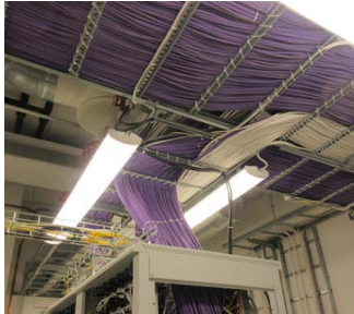
Figur 36: Kabelbroer for IKT
