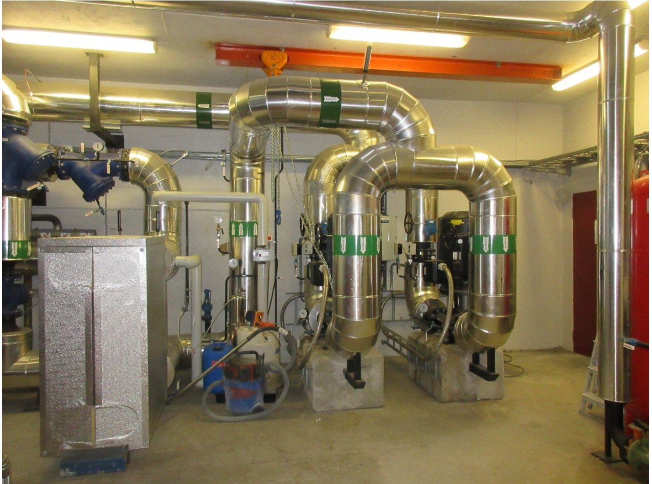
Figur 3. Varmesentral (fjernvarme) Lillehammer sykehus (foto Sykehusbygg)
